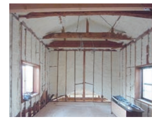
断熱材吹付工法を用い居間・寝室の壁・屋根裏・床下など部屋全体を包む様に施工
